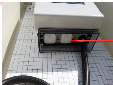
非常用コンセント
